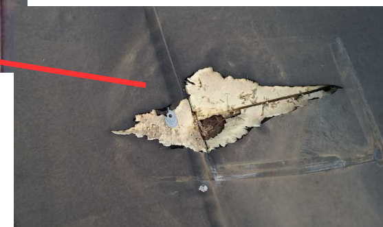
Foto 6: Particolare del deterioramento della copertura. Da questa grande fessura (~50 cm) si origina l'infiltrazione visibile nelle aule sottostanti [foto 2 e 3].
