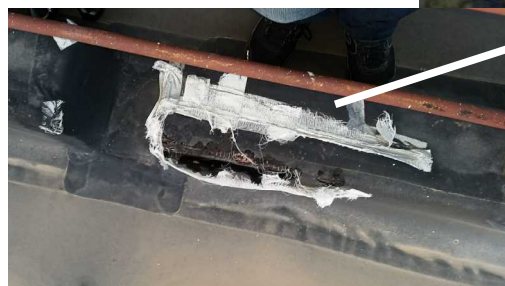
Foto 5: Particolare del deterioramento della copertura. Si notano evidenti segni di aggressione imputabili ad animali (cani randagi, topi, uccelli).
