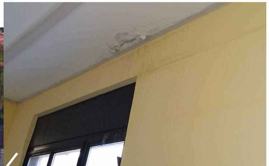
Foto 4: Piano 1 Infiltrazioni acque meteoriche dal soffitto.
